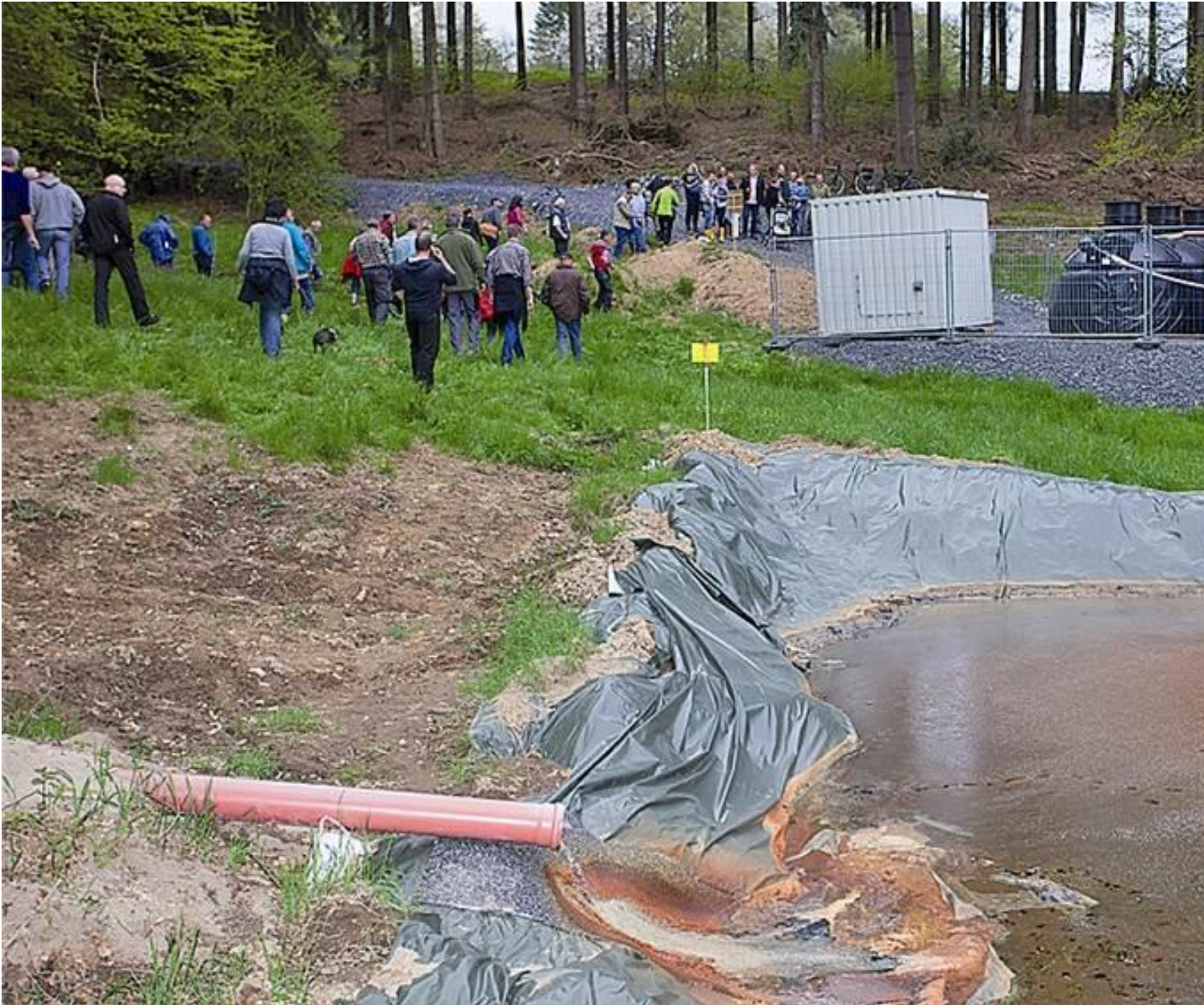
Vorne der provisorische Klärteich und im Hintergrund die mobile Kläranlage mit ihren Tanks. Foto: WT
