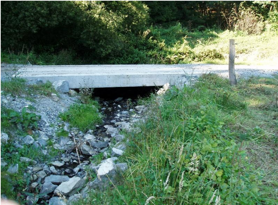
Abbildung 2: Betonplattenbrücke; das aus Schotter gebaute Fundament ist zum Bach hin mit Wasserbausteinen vor Erosion gesichert.
